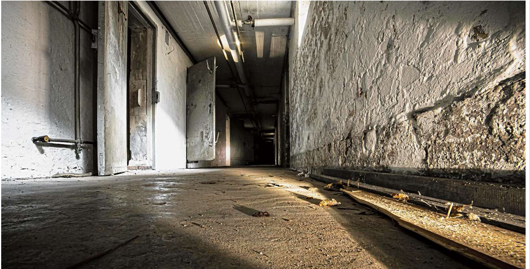
Das frühere Marineuntersuchungsgefängnis in der Wik: Bedrückend wirken die Zellen im Keller, der 1937 von den Nationalsozialisten gebaut wurde. Mehr als 500 Menschen sollen hier inhaftiert gewesen sein.
